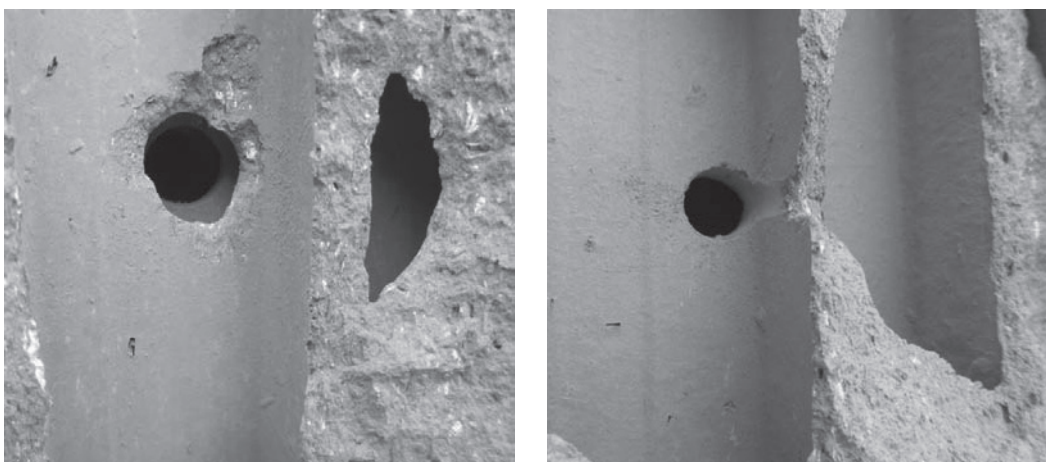
Obr. 2 Otvory pro osazení kotev ETICS. Vlevo - nekvalitně provedený otvor např. vrtáním s příklopem, oštipaný s nepravidelným tvarem a vpravo správně provedený otvor čistého kruhového tvaru.
