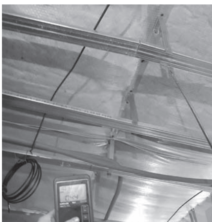
Obr.: 11: Spolehlivost parotěsné fólie jako hlavní vzduchotěsnicí vrstvy je problematická (foto z blower door testu).
