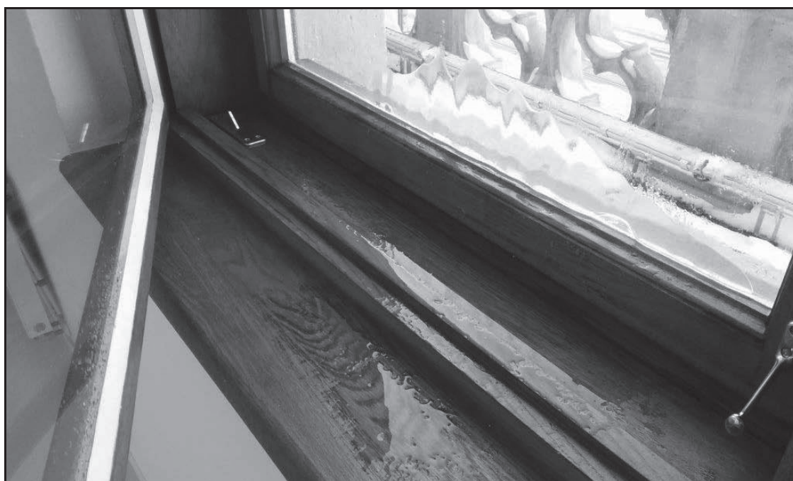
Obr. 2 – Foto parapetu – reálná kondenzace
