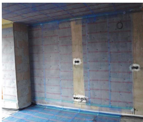
Obr. 4 Kapilárne rohože – celoplošná inštalácia na strope, podlahe i na stenách v rodinnom dome.
