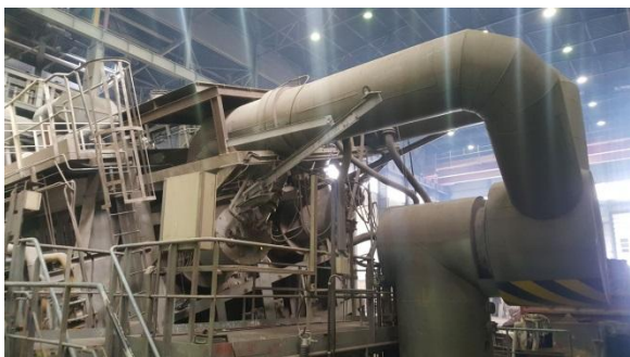
Obr.4: Pôvodný stav anódovej pece inštalácii dvoch Original state of anode furnace
