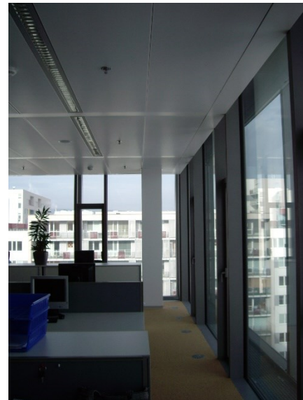
Obr. 3 Sálavé vykurovanie panelmi zavesenými pod stropom v administratívnej budove. V paneloch sú integrované vykurovanie, chladenie, osvetlenie, vetracie výustky, ako i protipožiarne zariadenie.
